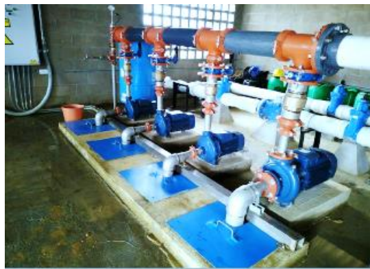
Bombas centrífugas – Conducción de agua tratada Fuente: propia
