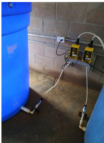
Tanque de preparación de cloro Fuente: Propia
