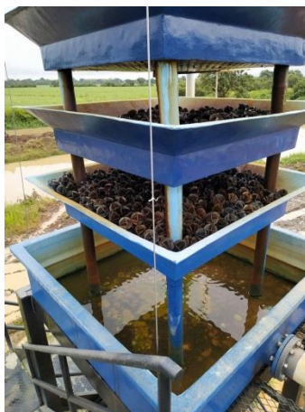
Torre de aireación Fuente: Propia
