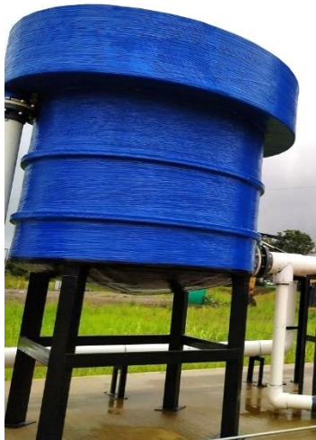
Vista lateral de la unidad de filtración Fuente: Propia
