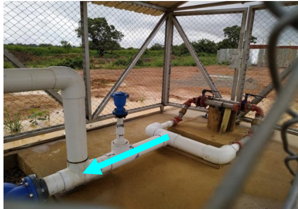
Captación y tubería de aducción Fuente: Propia
