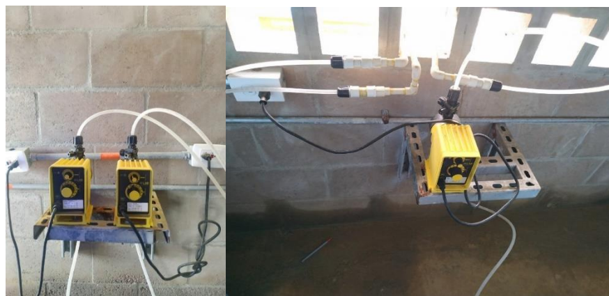
Bombas dosificadoras de productos químicos Fuente: propia
