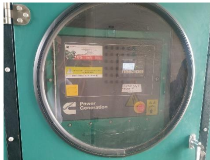
Planta de emergencia de la PTARD Fuente: Propia
