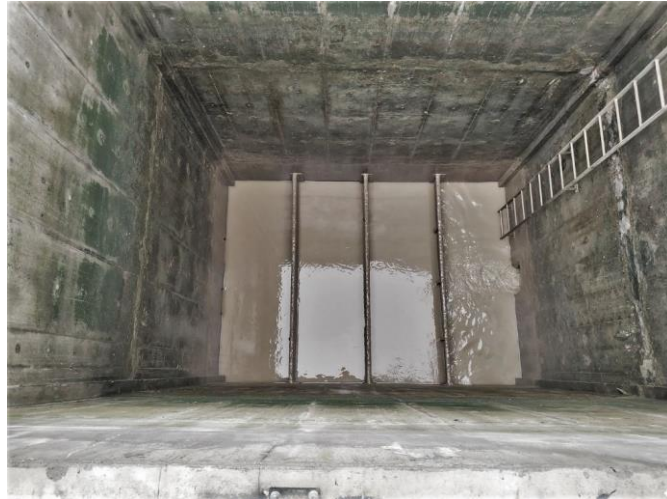
Trampa de grasas en sitio Fuente: Manual de Operación PTARD
