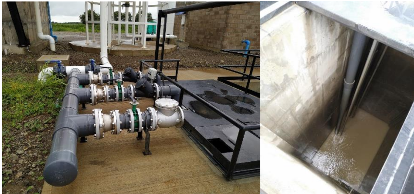
Estación de bombeo. (Izq.) Pozo de Bombeo (Der.) Fuente: Propia
