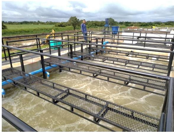
Tanque de aireación (reactor biológico)
