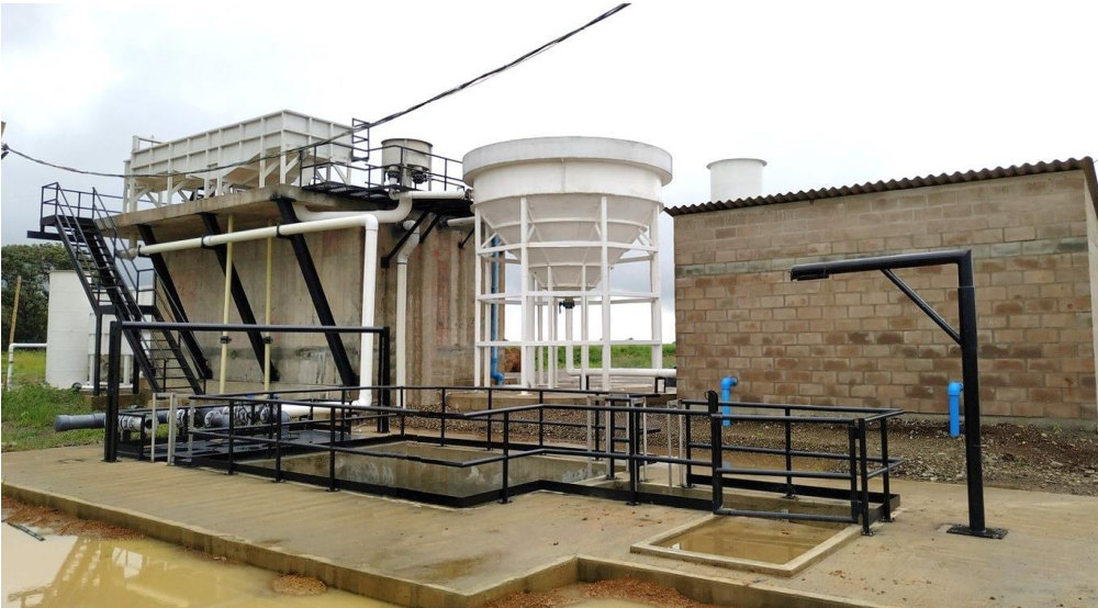
Vista en sitio de la PTARD desde la entrada a las instalaciones
