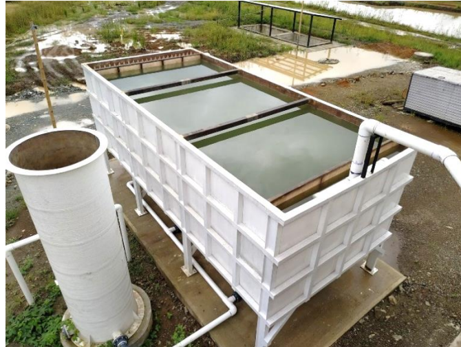
Sedimentador secundario y columna de lodos Fuente: propia
