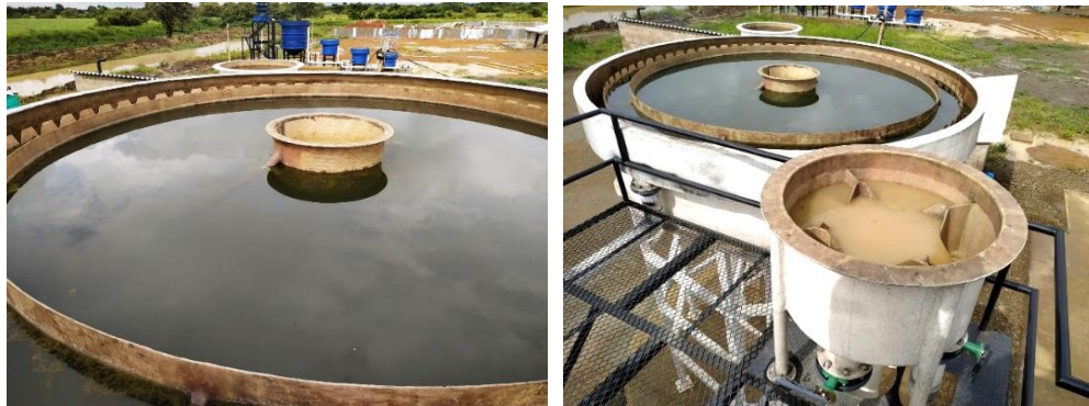
Reactores de lodos activados, vista superior Fuente: Propia
